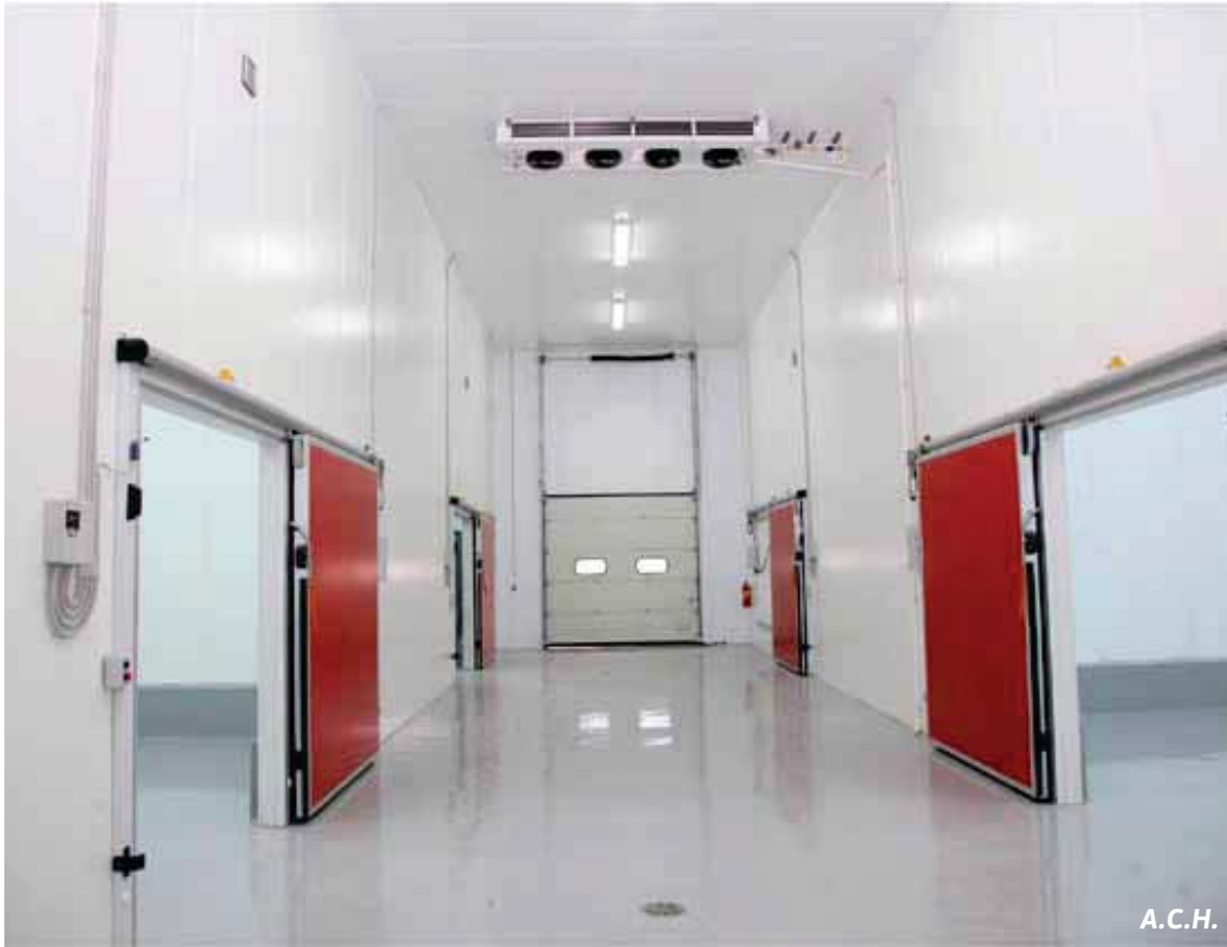
Εικόνα 1. Ψυκτικοί θάλαμοι και ψυχόμενος διάδρομος.
